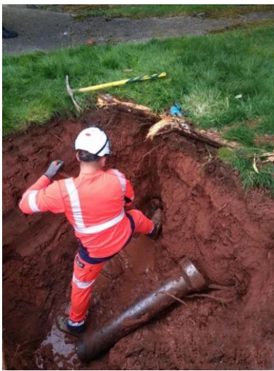
Réparation fuite d'eau rue des chênes
